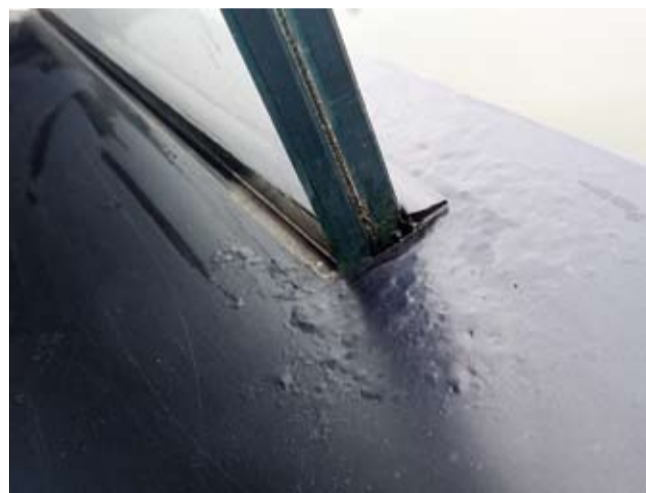
Gilt es zu vermeiden: Filiformkorrosion an Aluminiumfensterbänken
